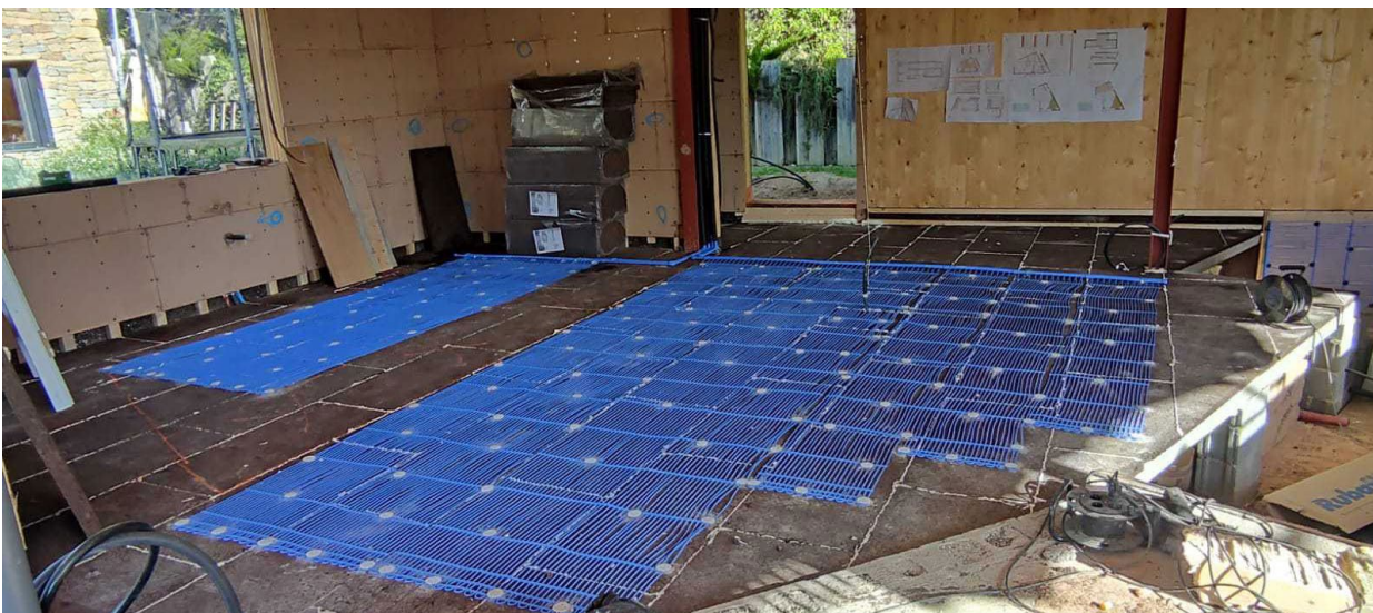
Fußbodenheizung und -kühlung im Estrich
