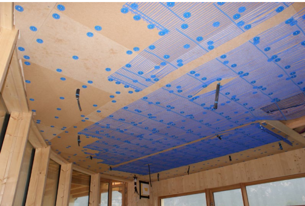
Heizung und Kühlung in Decke und Wand im Lehmputz
