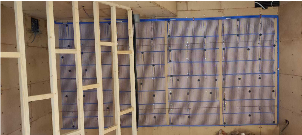
Wandheizung und -kühlung im Lehmputz
