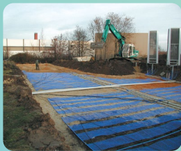
Erdkollektor (Kapillarrohrmatte aus Polypropylen)
